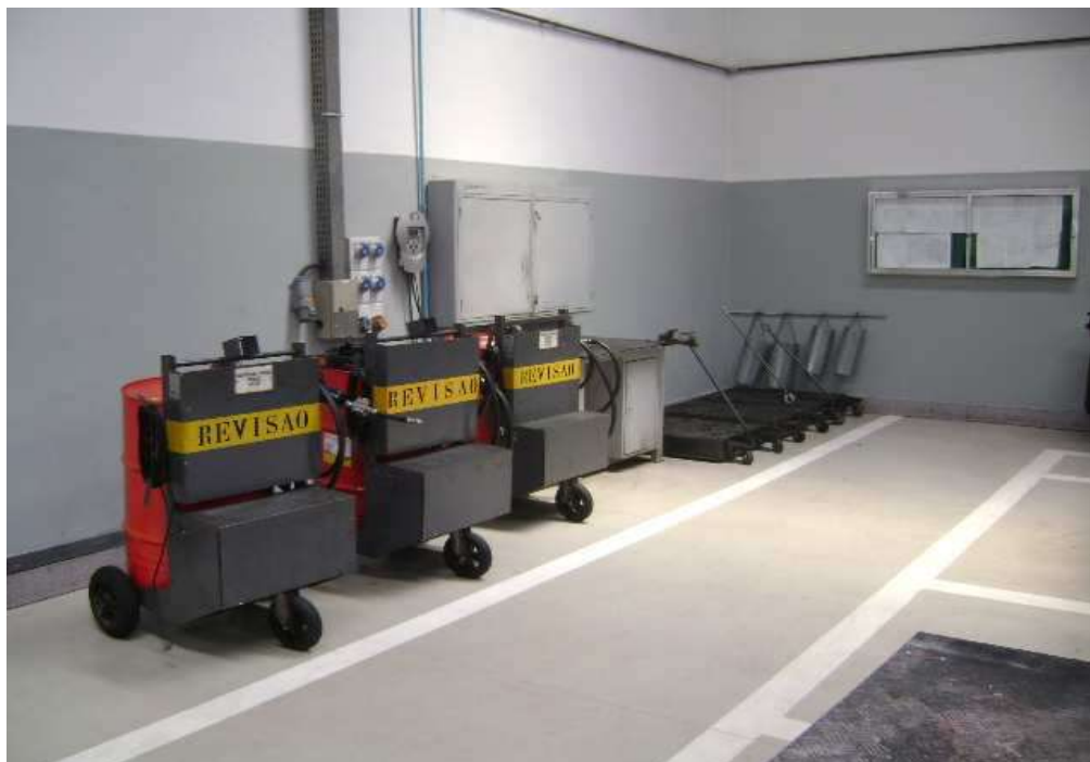
Foto 3 - Bombonas de óleos, carrinhos para descarte de óleos, tomadas elétricas, tomadas pneumáticas e quadro de ferramentas especiais.
